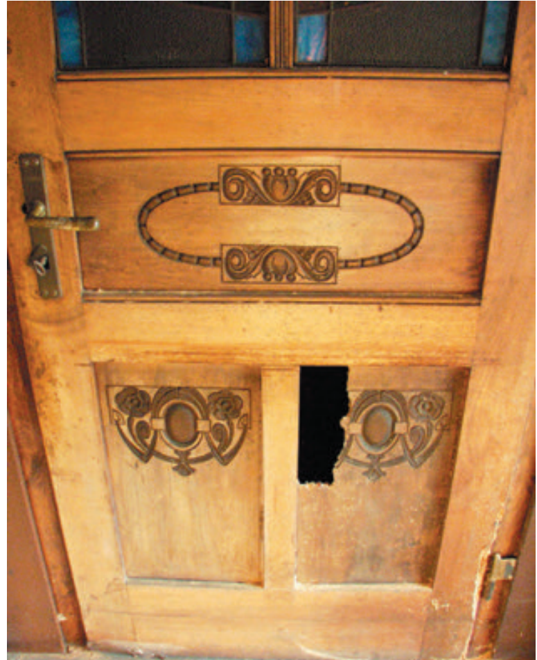
Zustand Jugendstiltür nach Schädlingsbefall, Juli 2003 | Foto: Margit Kreißl
