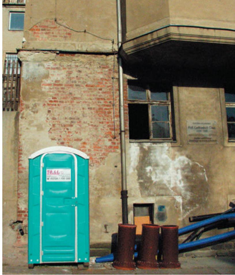
durchnässter Fassadenputz, Stand vor Mauertrockenlegung, Juli 2003 | Foto: Margit Kreißl
