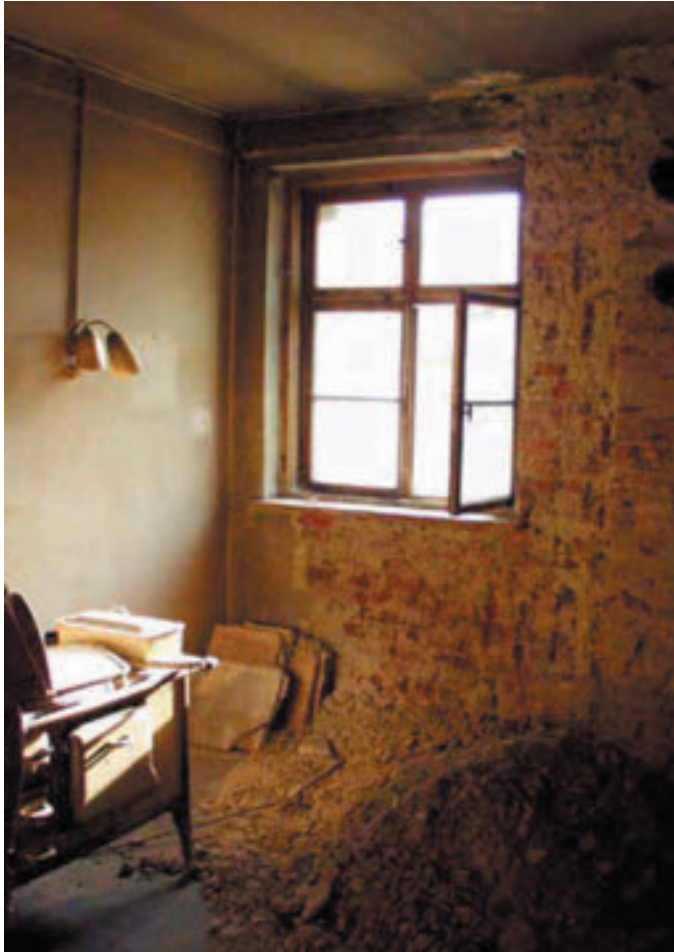
Wohnküche in leerstehender Wohnung, abgetragener, durchnässter Wandputz, Stand vor Mauertrockenlegung, Juli 2003 | Foto: Margit Kreißl/Annaberg-Buchholz
